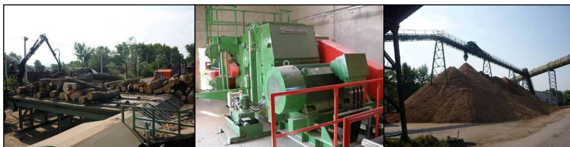
Ábra 27: Helyhez kötött, villamos meghajtású aprító berendezés egy szénerőmű területén
